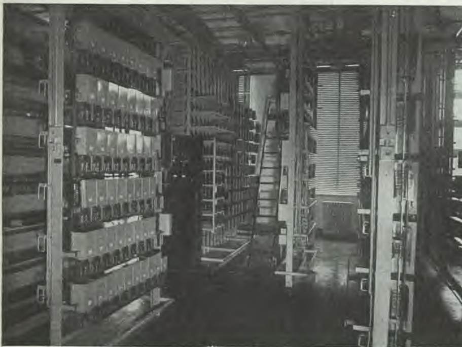
Fig. 3 — Bastidores de Equipamentos da Nova Estação Telefónica
