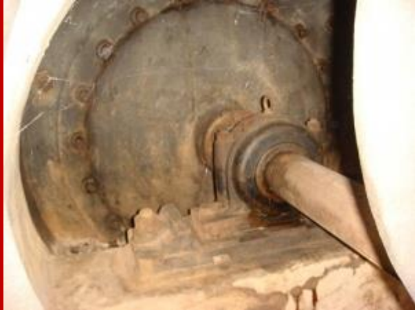
Turbina Francis N° 2
