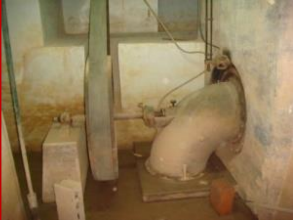
Turbina Francis N° 1
