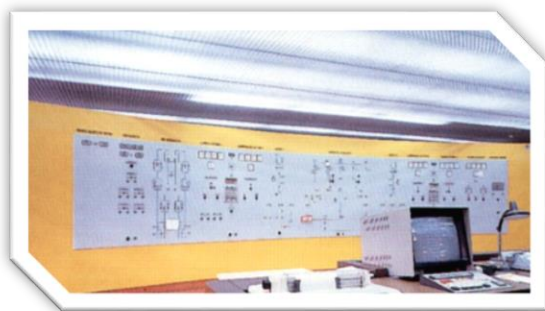
Sala de comando
