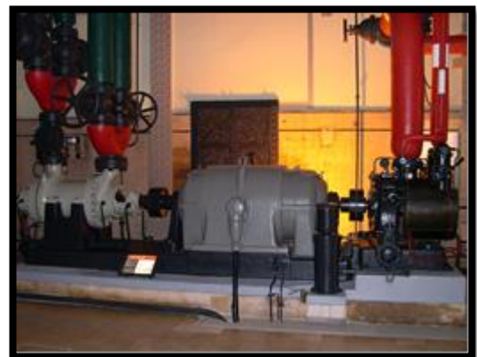
Turbo – electrobomba de água de alimentação
