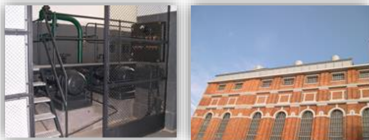
Bombas elevatórias e castelo de água
