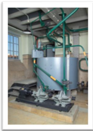
Tanque e bomba de reagentes
