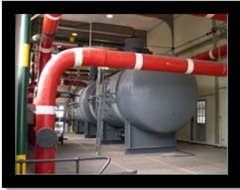
Reservatórios de água de alimentação
