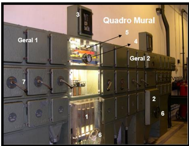
Quadro de distribuição
