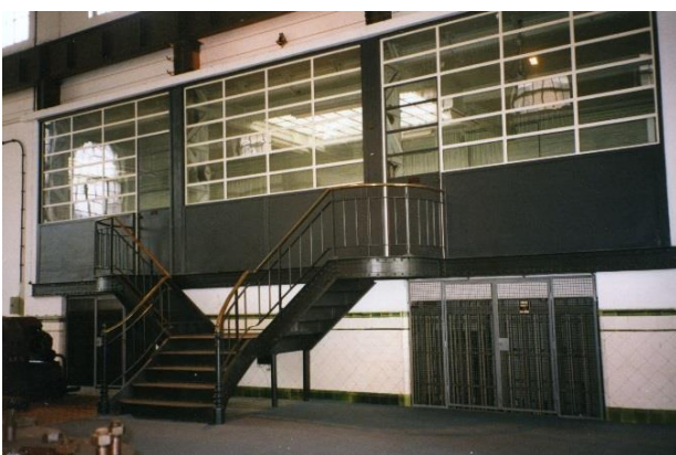
Vista da porta de grade da sala dos reóstatos dos alternadores, junto à escada na Sala das Máquinas, década de 1980.
