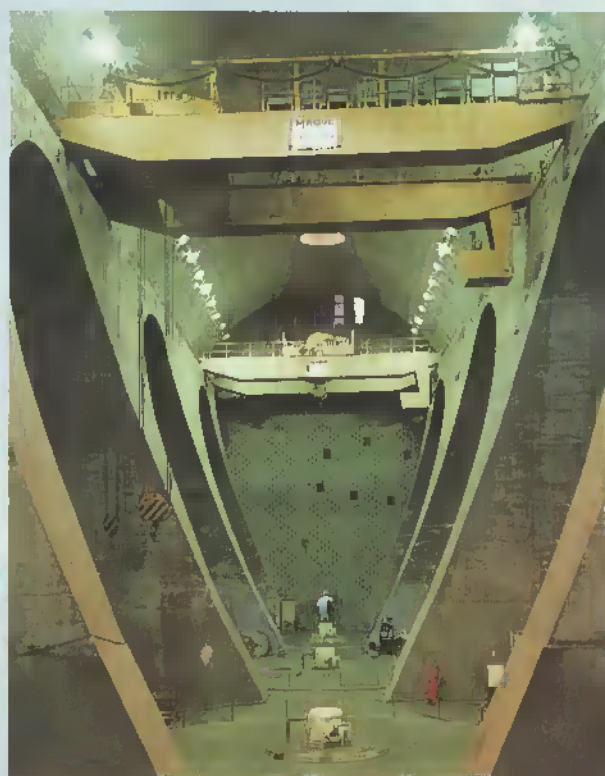
Sala de máquinas / Machine hall
